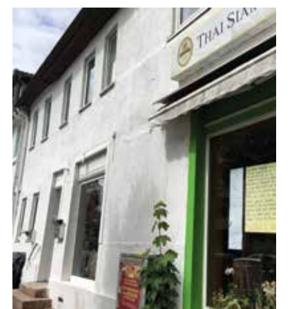
Dem Thai-Imbiss wurden vom Hausbesitzer Wasser und Gas abgedreht, die Häuserzeile in Alt-Rödelheim wird bewusst dem Verfall preisgegeben.
